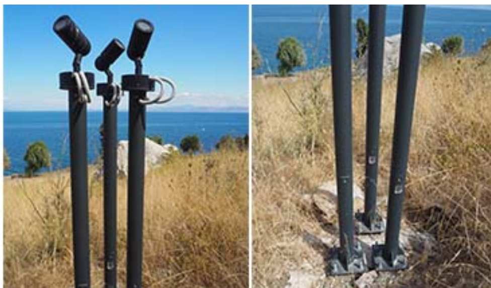
Εικόνα 5: Υφιστάμενη εγκατάσταση- προβολείς LED τοποθετημένοι πάνω σε ιστούς με βάση
